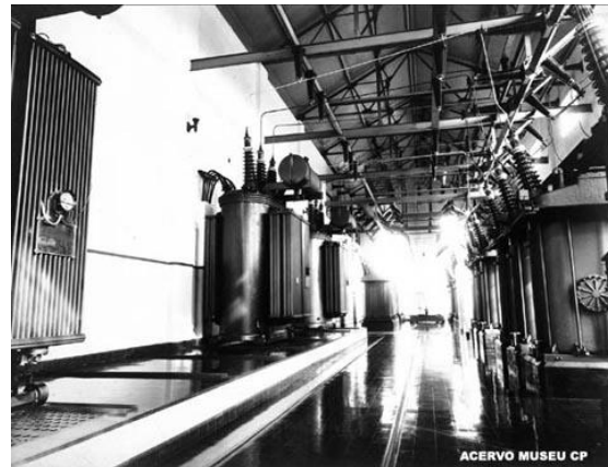
Figura 1.6: Conjunto de transformadores da subestação elétrica da Companhia Paulista em Louveira (SP). Foto do acervo do Museu da Companhia Paulista; esta cópia foi gentilmente mandada por Fernando Picarelli Martins
