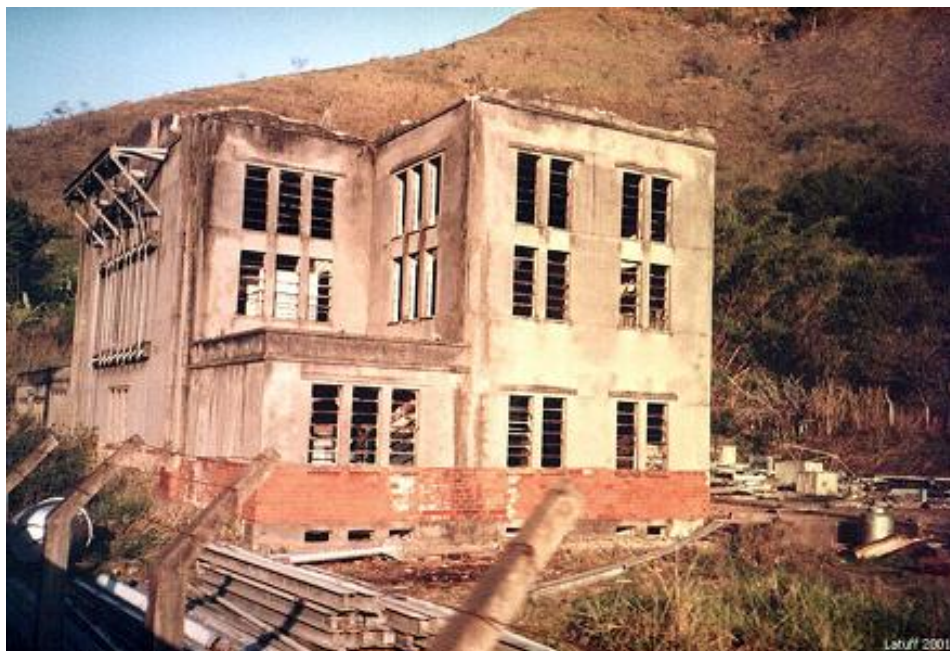
Figura 3.28: Resquícios da eletrificação na E.F. Central do Brasil no trecho entre Japeri e Barra do Piraí: ruínas do prédio que abrigava a antiga subestação de Scheid, na Serra do Mar. Foto de Latuff tirada em 16 de Outubro de 2001.
