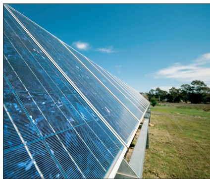
Painéis fotovoltaicos usados para a geração de eletricidade a partir da luz do sol (Fonte: Rhodia)
